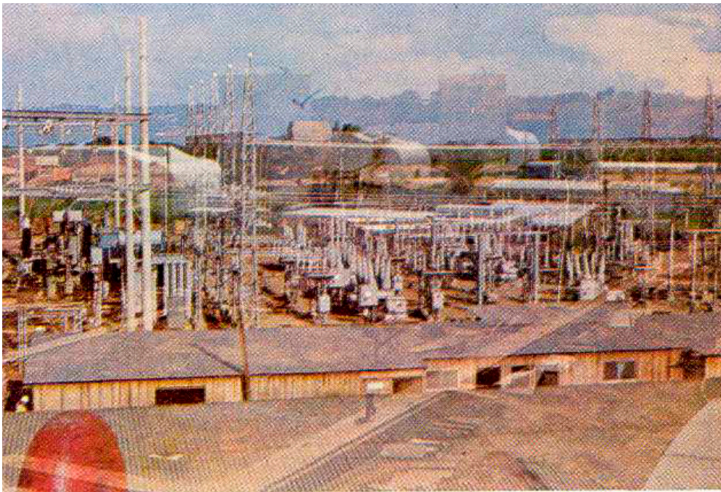
SUBESTACION HUARACACHI (SANTA CRUZ).
